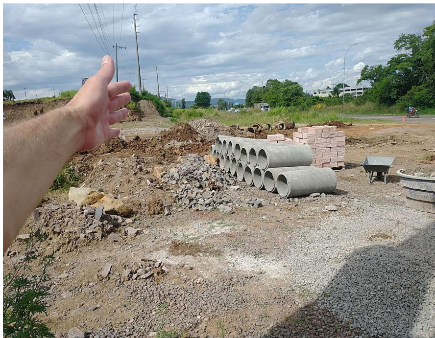
Intervenções não autorizadas nas laterais das rodovias oferecem riscos a usuários
